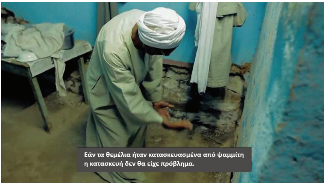
εικ.129: Στο χωριό New Gourna τα θεμέλια των κτιρίων κατασκέφρονται από το σχηματισμό αλάτων
