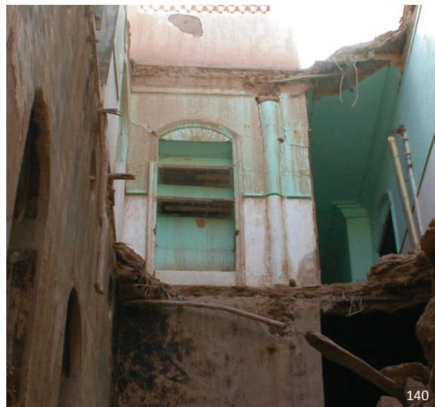
εικ.140: Κατάρρευση πατωμάτων και στέγης στο εσωτερικό της κουζίνας της βορειοανατολικής πτέρυγας
