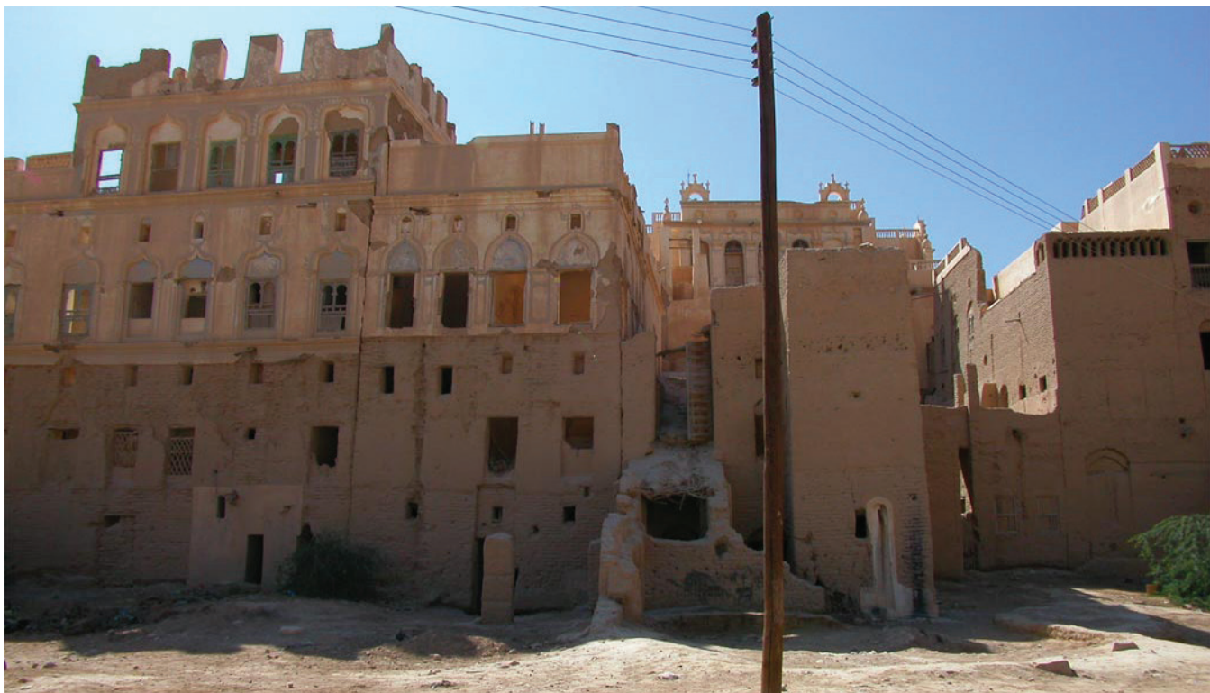
εικ.143: Βόρεια όψη (στο κέντρο φαίνεται η ράμπα για την καμήλα που περνά πάνω από την ισόγεια κουζίνα του Dar Dawil και τμήμα της έχει καταρρεύσει)
