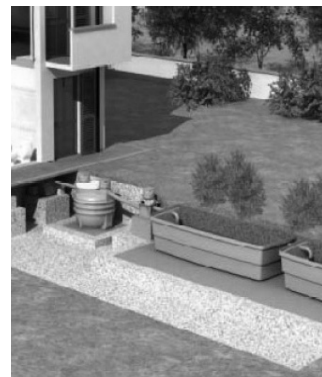
Εικ.5: Λεκάνες φυτοκαθαρισμού σε κατοικία
